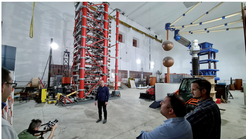
Obr. 7. Laboratórium vysokých napätí FEI STU. Transformátorová kaskáda s maximálnym výstupným napätím 1200 kV, 1500 kVA a generátor napätového impulzu s amplitúdou do 2500 kV a energiou 100 kJ.
